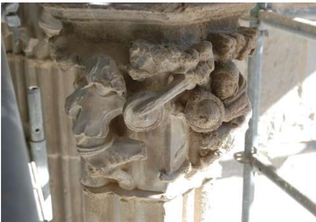
Foto 1. Capitel de combate de híbridos de humano y dragón. Se observa el avance de deterioro y la diferencia de estado de conservación de la zona más expuesta al exterior y la más interna. Fotografía Gobierno de Navarra
